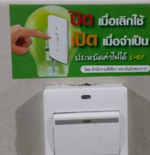
สวิตไฟทางเดินในอาคาร
